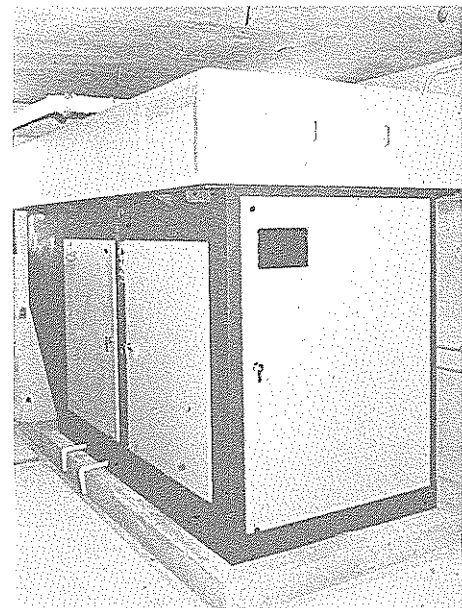
年金積立金の融資で完成した自家発電装置
