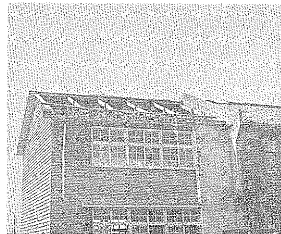
写真左 吹き抜けた屋根。 || 香南中 ||
