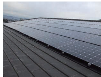
太陽光発電設備
