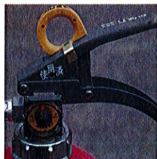
× 表示装置の脱落
