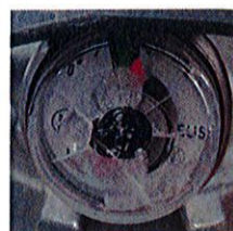
× 指示圧力計の損傷
