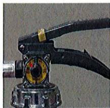
× 安全栓の脱落
