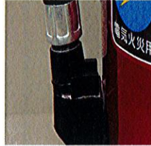
× 消火薬剤の漏れ
