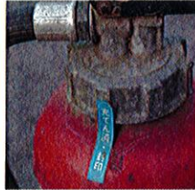
× キャップの劣化
