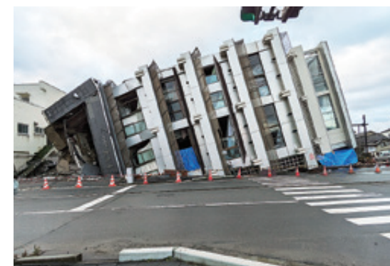
倒れた7階建て五島屋ビル
