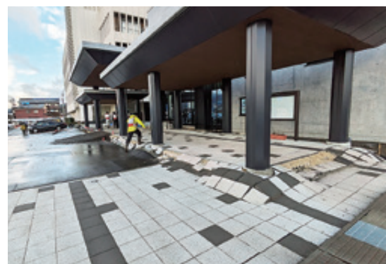
玄関前が陥没した輪島市役所庁舎
