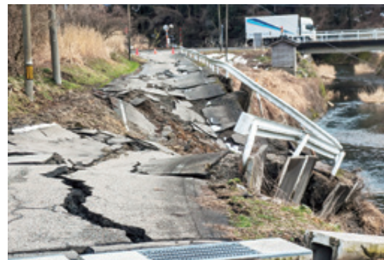
河川護岸崩壊
