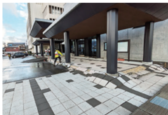
玄関前が陥没した輪島市役所庁舎
