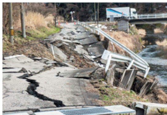
河川護岸崩壊
