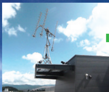
衛星通信アンテナ
