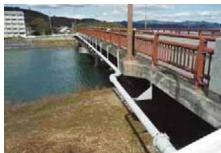
上水耐震管路
