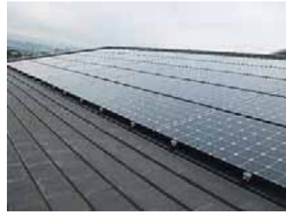
太陽光発電設備
