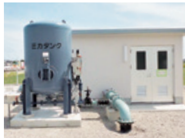
浜改田西部工区4号揚水機場
