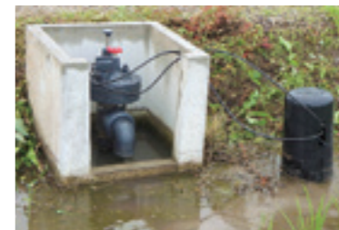
自動給水装置 (浜改田西部工区)
