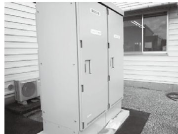
北部出張所蓄電池
